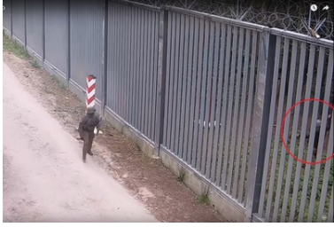
Niszczenie znaku granicznego
